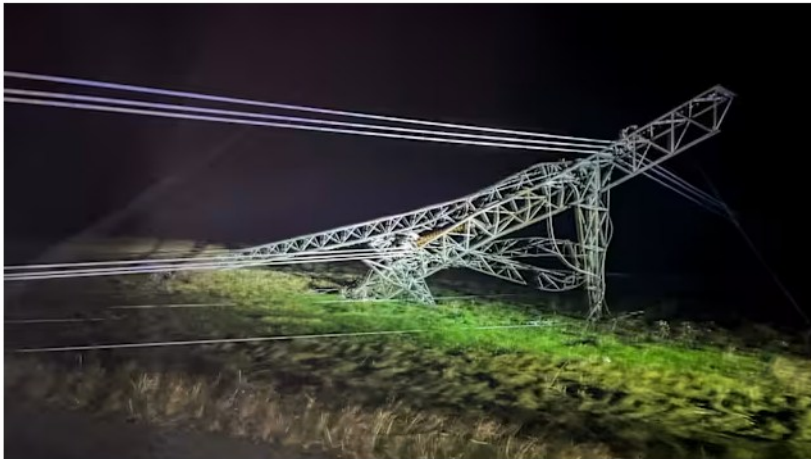
Kaatonut voimalinja Eurajoella Auvintien ja Verkkokarintien risteyksen kohdilla 2.11.2024. Kuva: Fingrid
