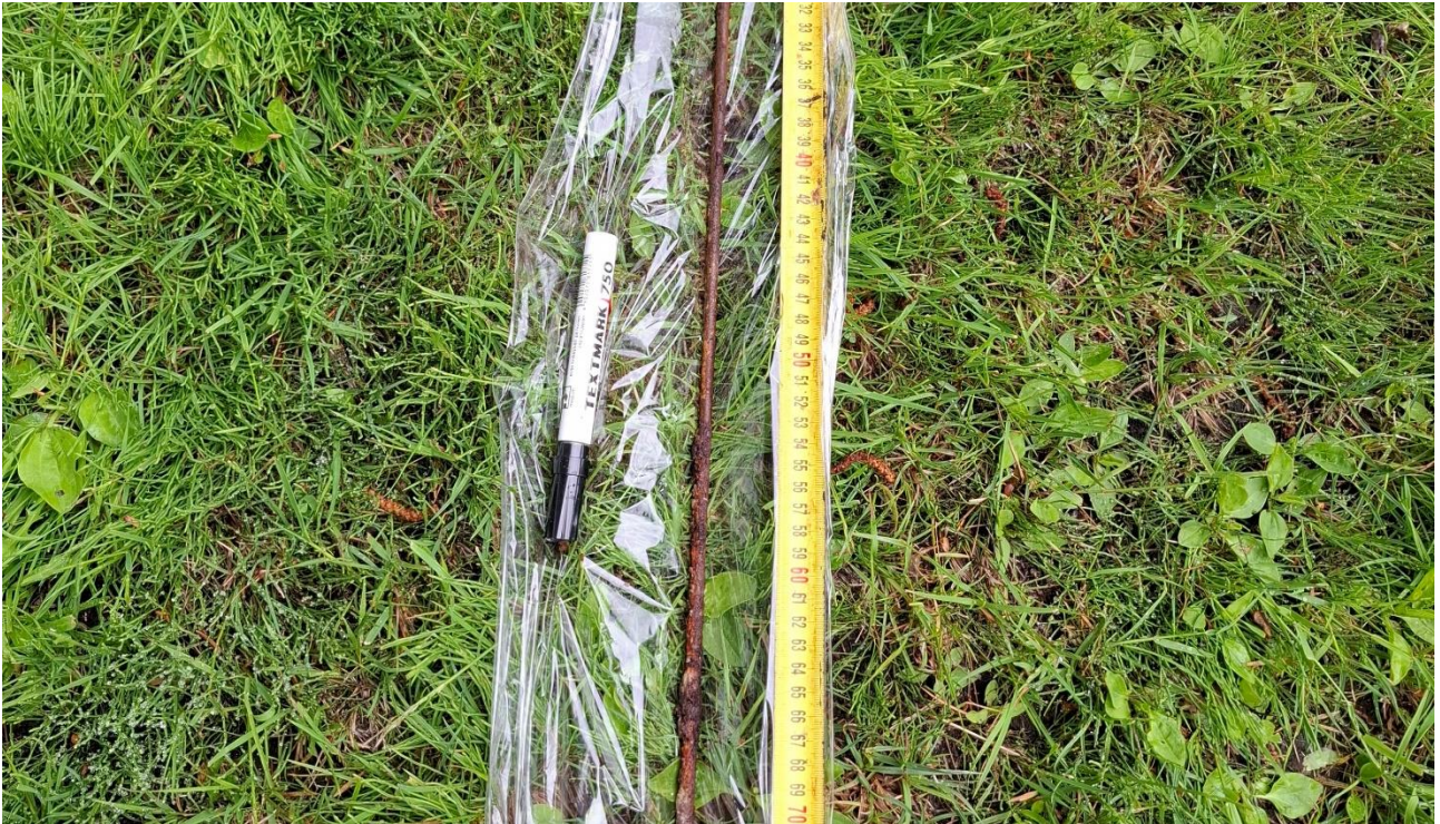
Kuva 6. Heikkilänkankaan ylösnostettu mustarauta tanko, jossa jo silminnähtävää korroosiomuutosta.
