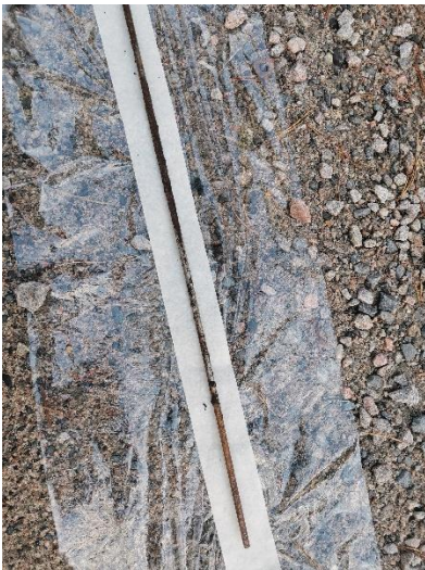
Kuva 5. Maasta nostettu tanko, jossa ei vielä silminnähtävää korroosiota havaittavissa. Kuva: Mirkka Visuri
